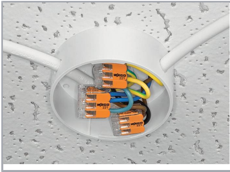
Leuchtenverteilung in Deckenbaldachin
